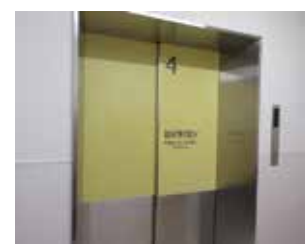
ゴミ運搬専用エレベーター
