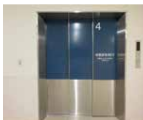
栄養部専用エレベーター
